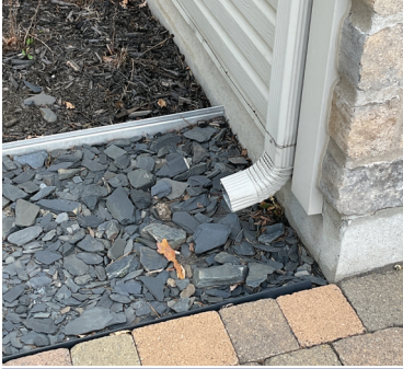
Un rejet trop près du bâtiment (moins 1,5 mètre)
