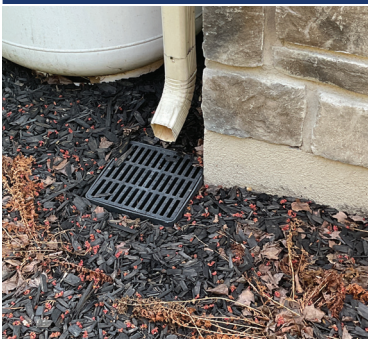
Un rejet dirigé directement dans un puisard
