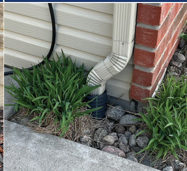
Un rejet dirigé directement dans le drain de fondation
